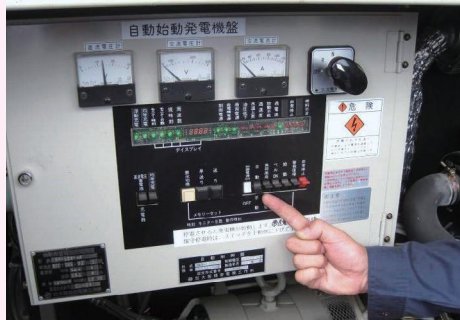
市施設の非常用自家発電設備負荷運転試験
